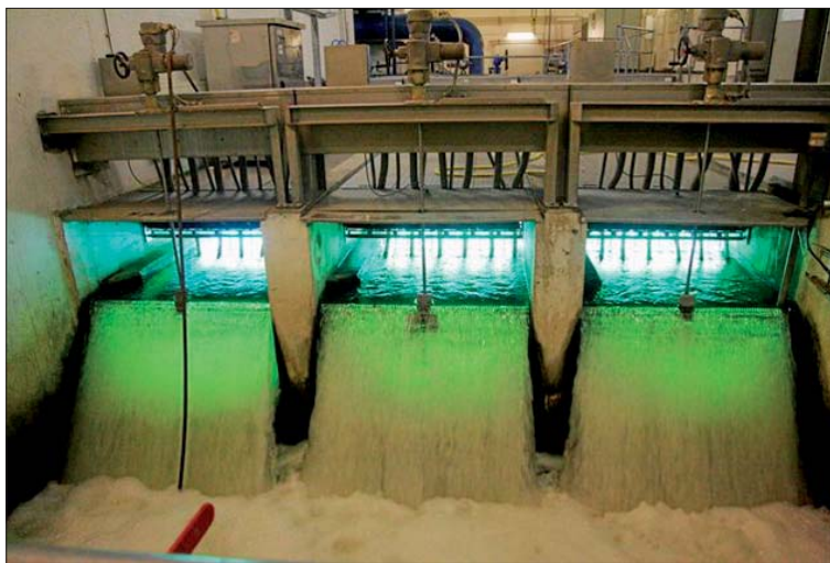
Рис. 2. Установка ультрафиолетового обеззараживания на очистных сооружениях Южного Бутова
